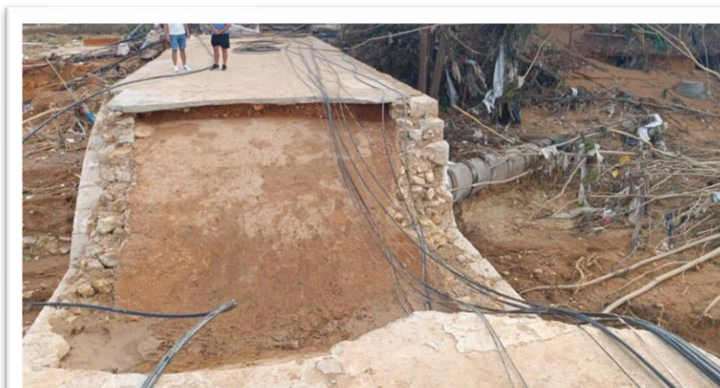
Fibra óptica dañada por rotura de puente
